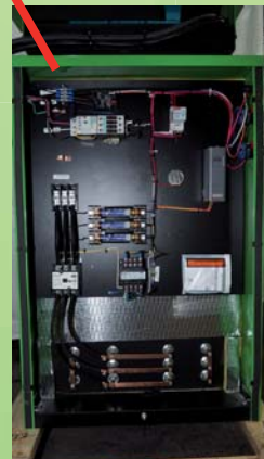
Panneau électrique Electrical panel
